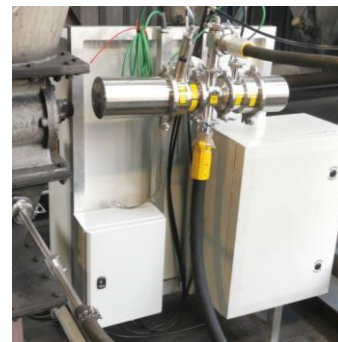
Fig. 2 : Insittec avec portique et coffrets installés sur la ligne de production
